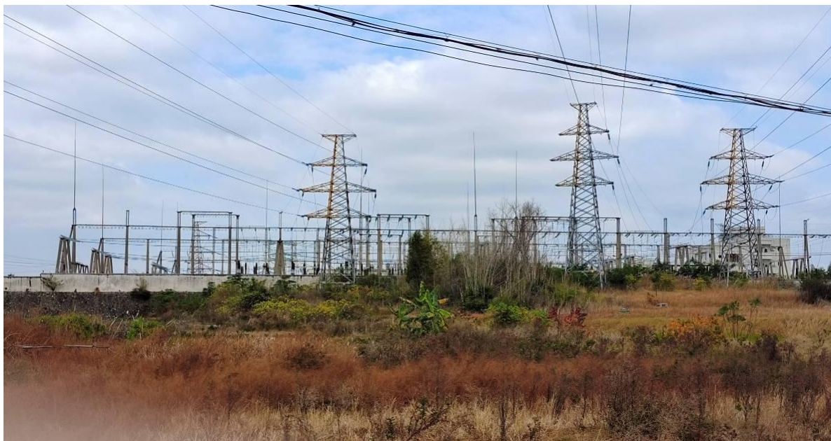
220kV 兴宁站 110kV 侧出线现场照片
