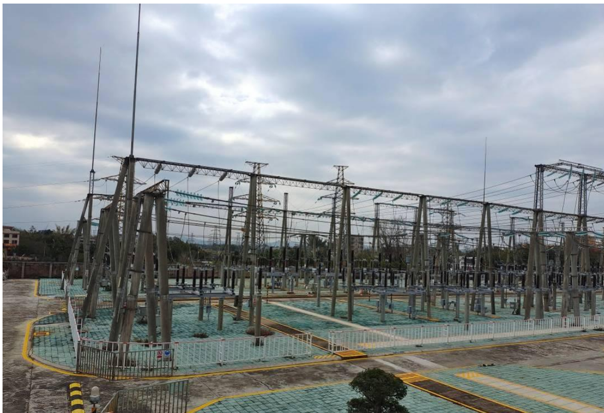
220kV 兴宁站 110kV 间隔现场照片
